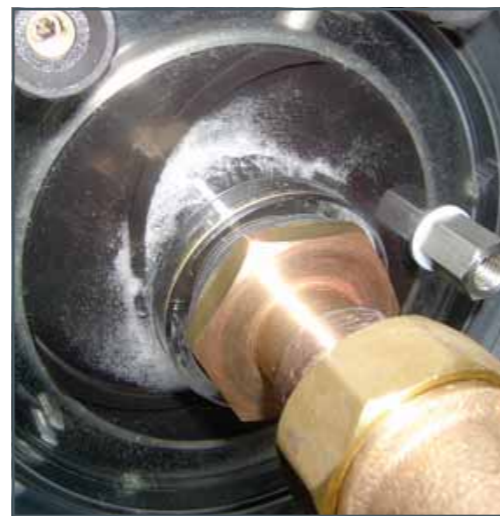
Dampfblasenbildung durch Kavitation an einem Pumpenlaufrad (HM 380)
