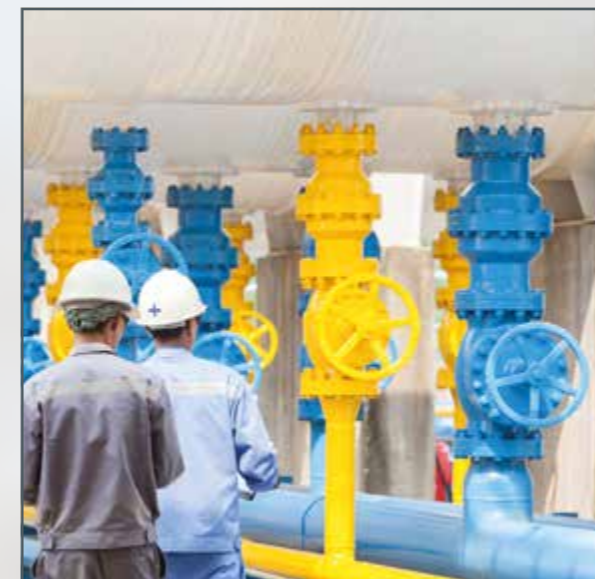
Armaturen einer großtechnischen Verteilerstation
