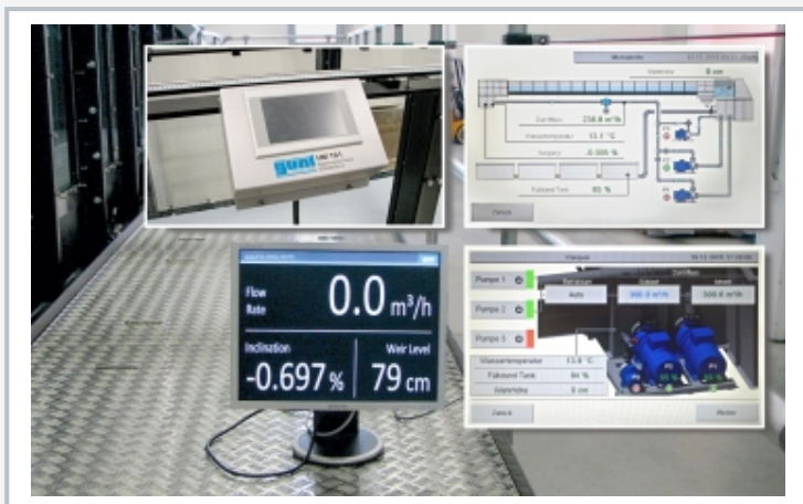
Monitor mit Anzeige der Messwerte und Betriebszustände, frei positionierbares Touchpanel (links) und Screenshots der SPS (rechts)
