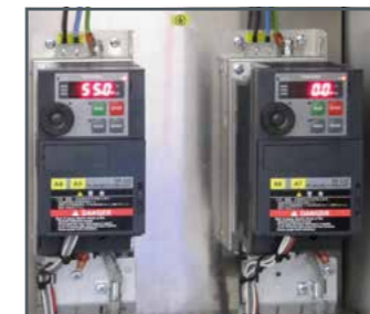
Frequenzumrichter zur Steuerung der Pumpen
