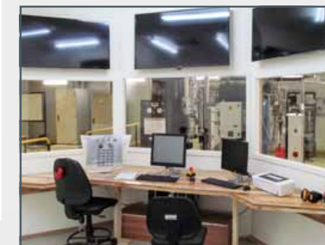
Module D Poste de commande
