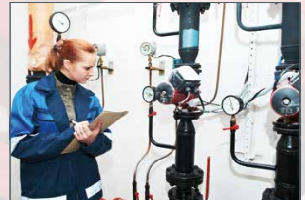
Contrôle des composants de l'installation
