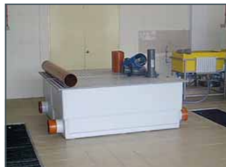
Wasserbehälter und Verrohrung
