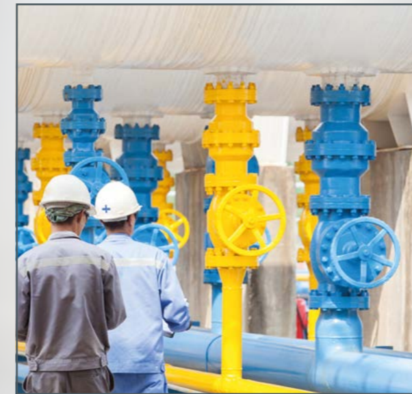
Armaturen einer großtechnischen Verteilerstation
