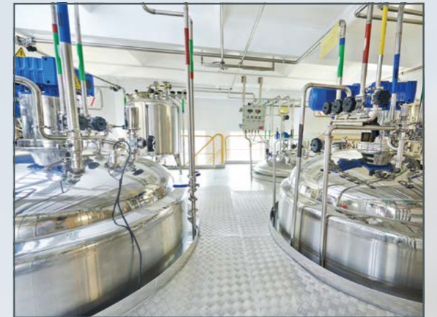
Rührbehälter im großtechnischen Maßstab
